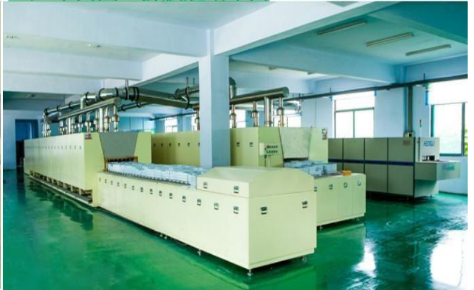
工厂车间图：排胶烧结车间
