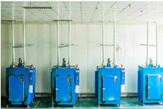
工厂车间图：箱式排胶车间
