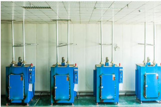
工厂车间图：箱式排胶车间
